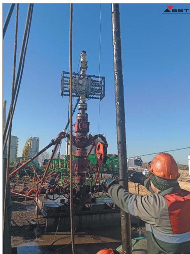
Рис. 15. Извлечение отстрелянной компоновки
